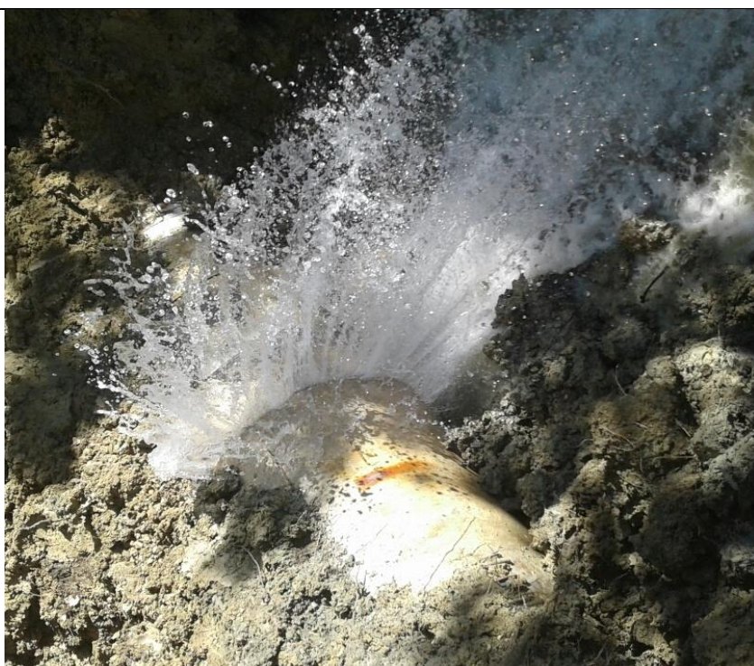
Sisma 2016: Rottura condotta Acquedotto Pescara
