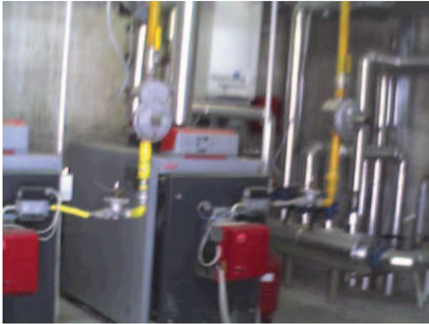
Foto 1a – caldaia in centrale termica -Immagine reale
