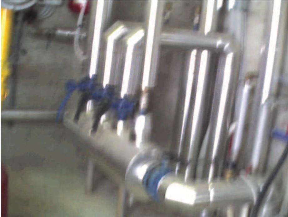
Foto 3a- tubazioni isolate in centrale termica
